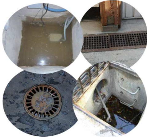
Réseau pluvial extérieur / Puisards / Regards
